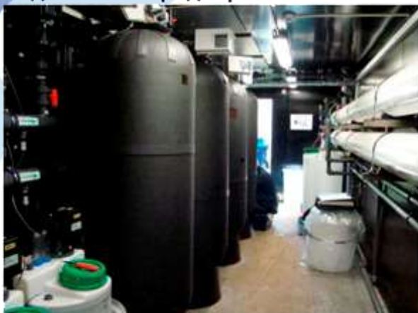
Вид на блок предварительной очистки
